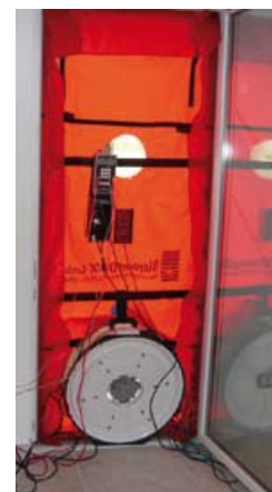
Apparecchiatura per il blower door test, la verifica della permeabilità all'aria dell'edificio prevista dalle certificazioni di qualità.
